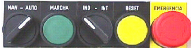
Figura 38: Botonera de control del Módulo 3
