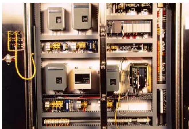
Fig. 2.4. Instalación industrial con utilización de buses de campo.
