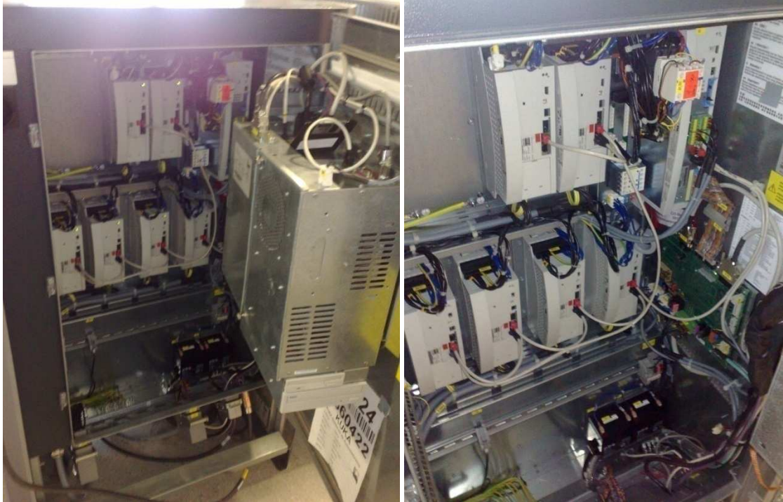
Fig. 2.29 – Fotos interior d'un armari de la sala de formació.
