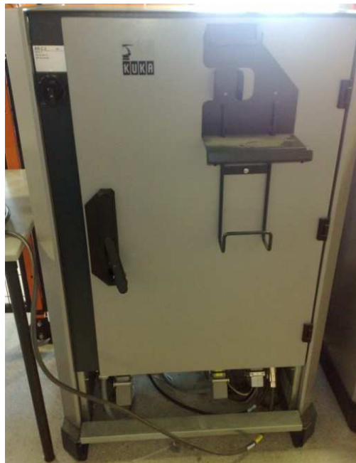
Fig. 2.30 – Foto exterior d'un armari de la sala de formació.
