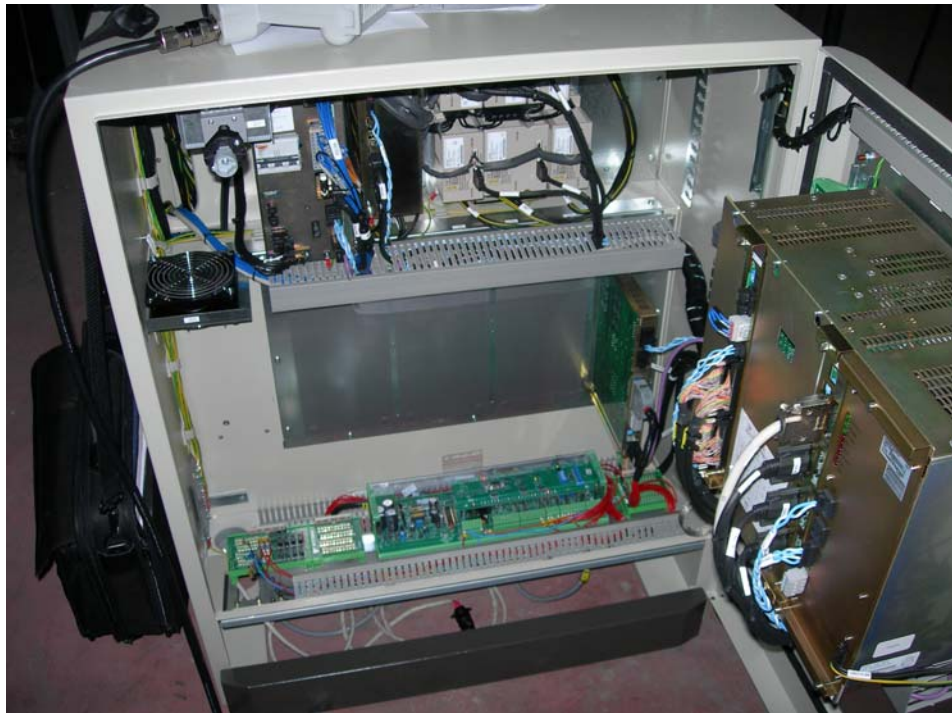
Fig.24-bis. Imagen del interior del armario eléctrico de la computadora NX100 de Motoman robotics. Se aprecian los elementos mostrados en las figuras 23 y 24.
