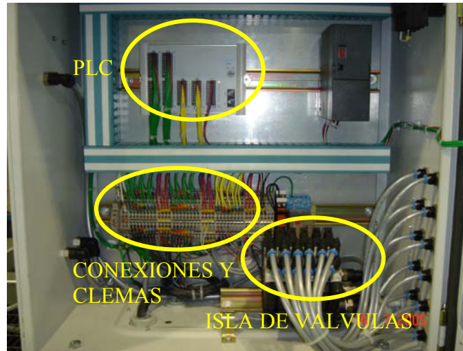
Figura 4.66 Acomodo de instrumentos dentro del gabinete de control.
