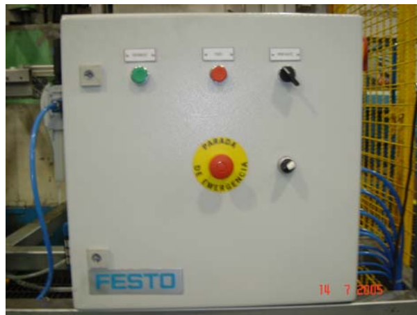
Figura 4.65 Gabinete de control
