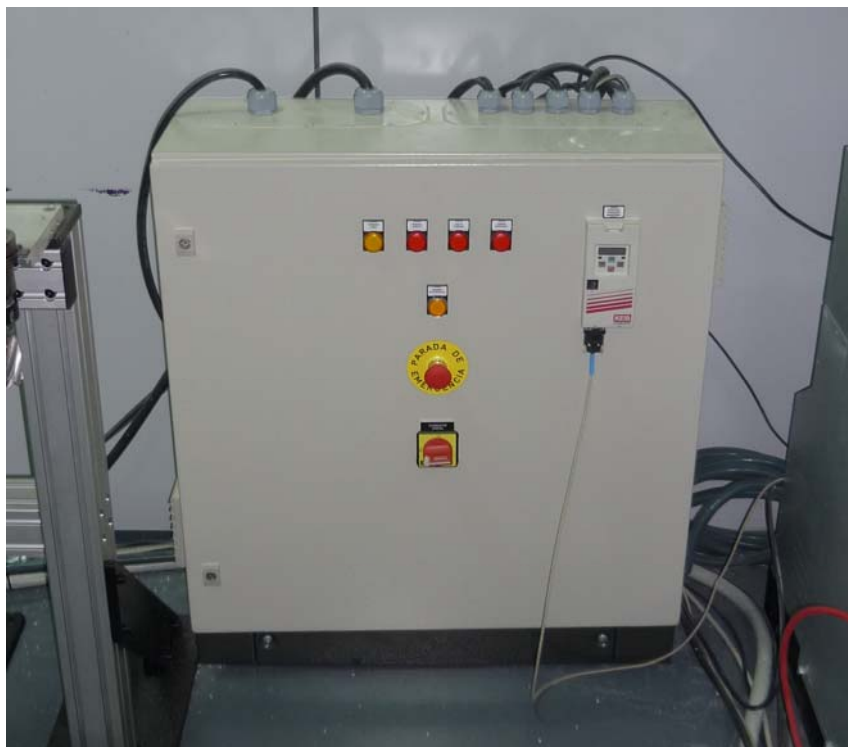
Figura 32: Armari Controlador del Mandr 
