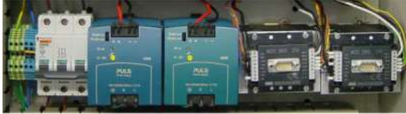
Figura 5.2. Armari de control; línia de potència
